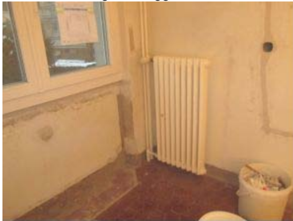
Heizungsrohre im Raum freistehend
