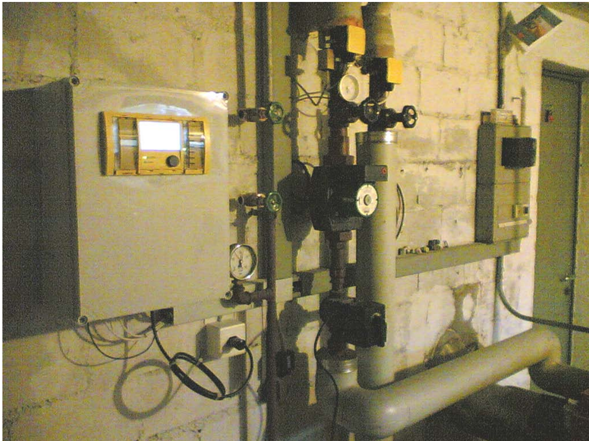
Bild der Anlage, links der Experimentierregler, rechts bei der Türe der konventionelle Kesselregler
