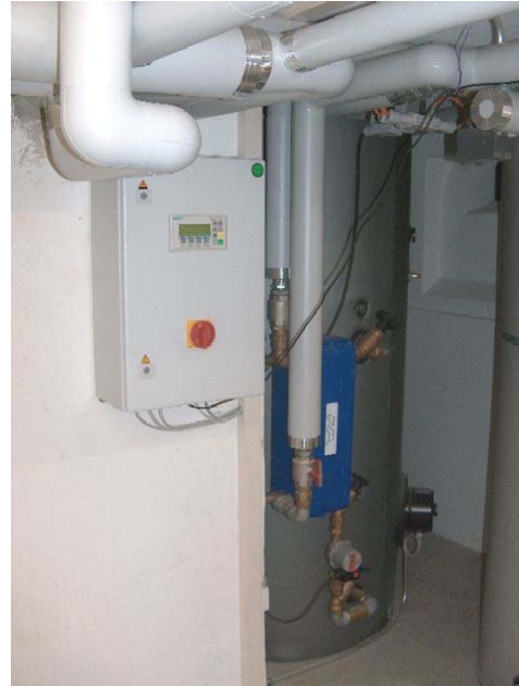
Heizungskeller, Steuerkasten (Simatic S7)
